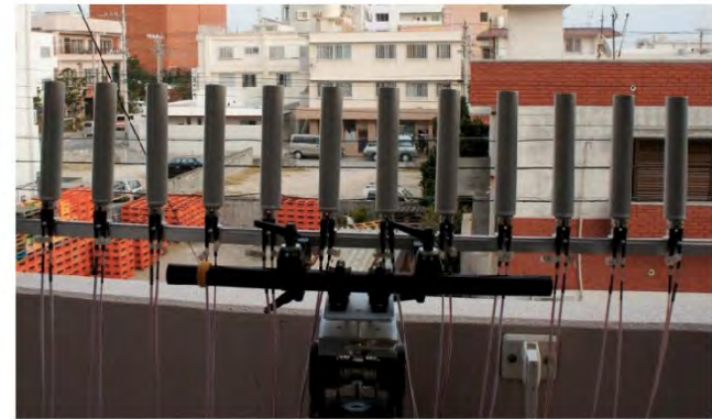
基地局アンテナアレー
